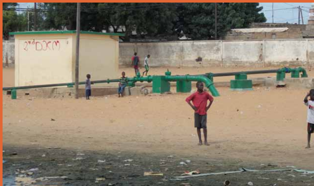
Station de pompage d'eaux souterraines à Dakar
